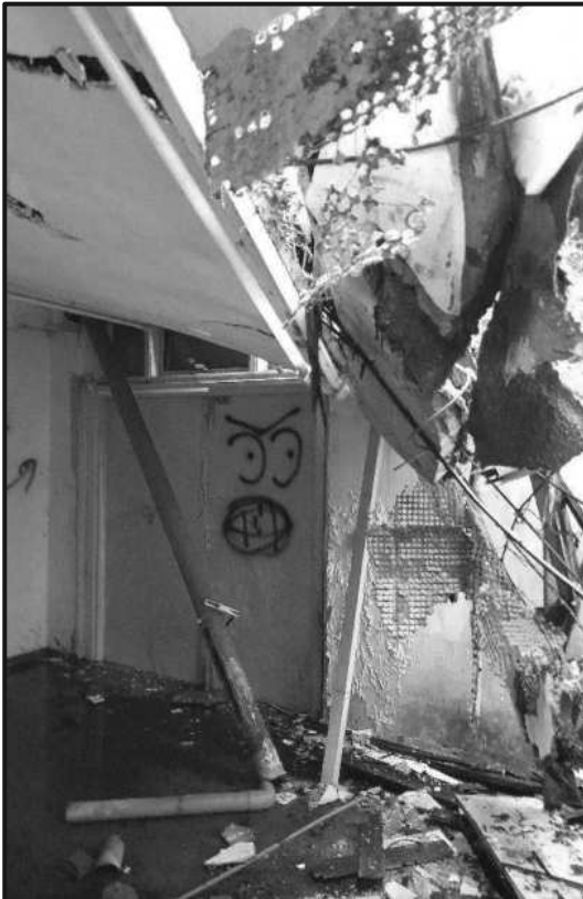
Binnen in het compleet vervallen gebouw is door het ingevallen plafond de buitenlucht te zien.
